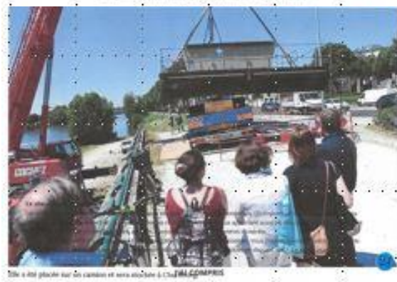
Figures 18 à 21. Hydroturbines
