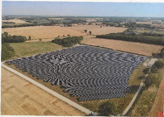
Figure 4 et 5. Fermes de panneaux solaires
